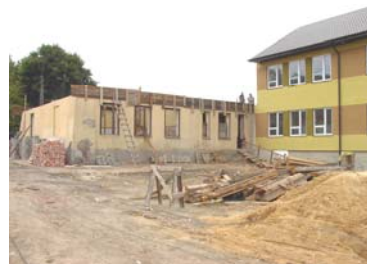
obecnie trwają prace przygotowawcze do wykonania stropu, poniżej widok na belki stropowe wewnątrz budynku
